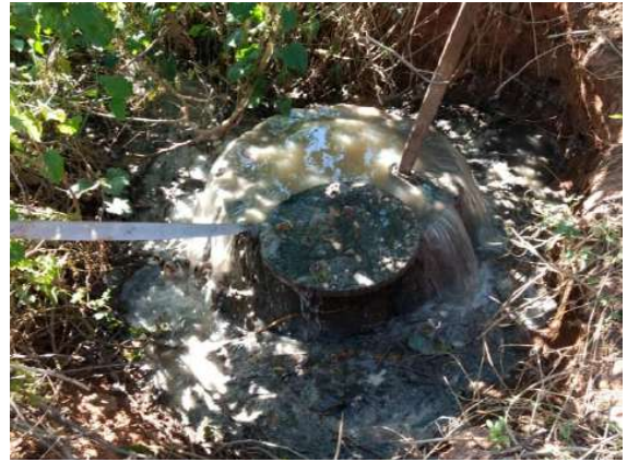
Foto 3.50 – PV transbordando e despejando esgoto na voçoroca
