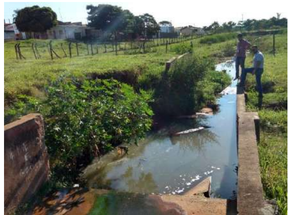
Foto 3.52 – Escada hidráulica – Vista do desmoronamento
