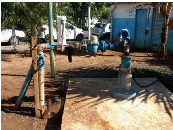
Foto 3.7 - Identificação do Poço: P10
