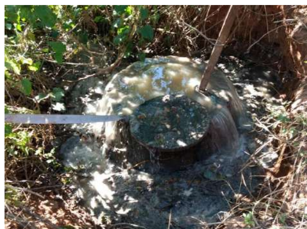
Foto 3.33 – PV transbordando e despejando esgoto na voçoroca
