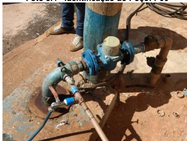
Foto 3.6 - Identificação do Poço: P08
