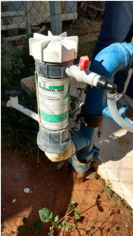
Foto 3.23 – Desinfecção no poço através de dosador automático de Flúor e Cloro
