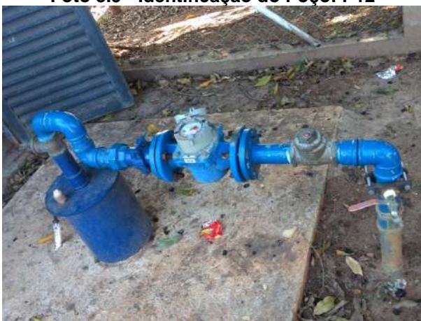
Foto 3.11 - Identificação do Poço: P14
