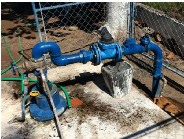
Foto 3.1 - Identificação do Poço: P01
