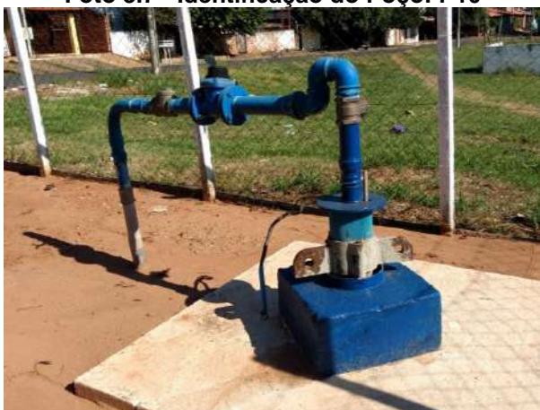
Foto 3.9 - Identificação do Poço: P12
