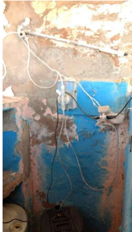
Foto 3.22 – Desinfecção no poço através de bomba dosadora
