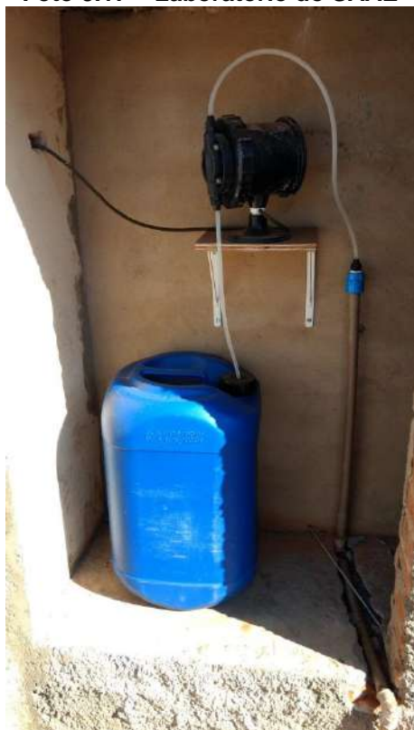
Foto 3.19 – Desinfecção no poço através de bomba dosadora
