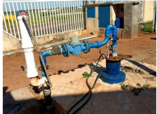
Foto 3.14 - Identificação do Poço: P17
