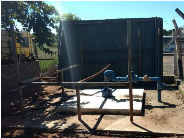
Foto 3.13 - Identificação do Poço: P16
