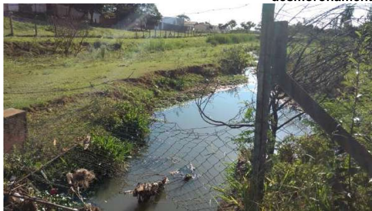
Foto 3.53 – Fim da escada hidráulica – reservatório de retenção
