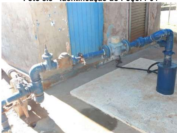
Foto 3.5 - Identificação do Poço: P07
