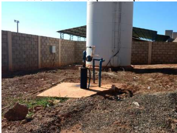
Foto 3.15 - Identificação do Poço: P18
