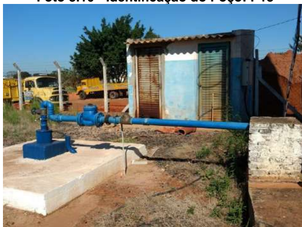
Foto 3.12 - Identificação do Poço: P15
