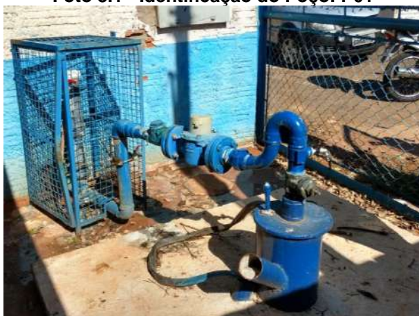
Foto 3.3 - Identificação do Poço: P04
