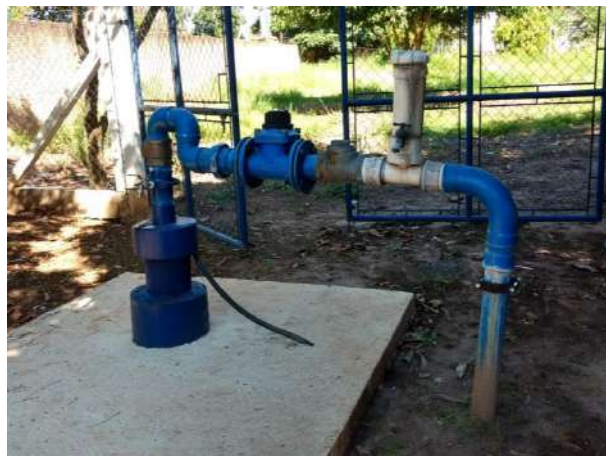
Foto 3.8 - Identificação do Poço: P11
