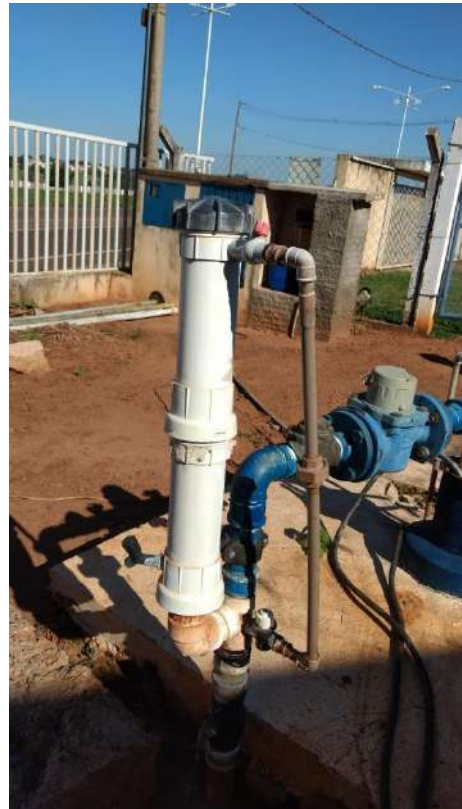
Foto 3.24 – Desinfecção no poço através de dosador automático de Flúor e Cloro
