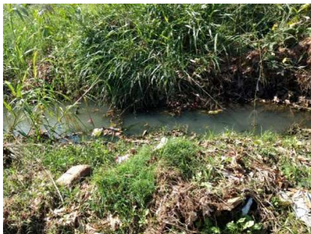
Foto 6.49 – Esgoto transbordando devido ao emissário rompido na região da voçoroca
