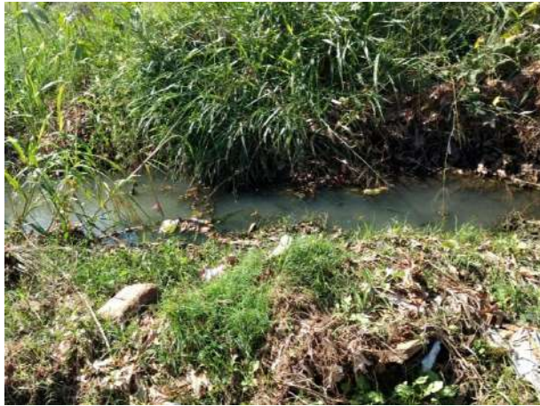
Foto 6.32 – Esgoto transbordando devido ao emissário rompido na região da voçoroca
