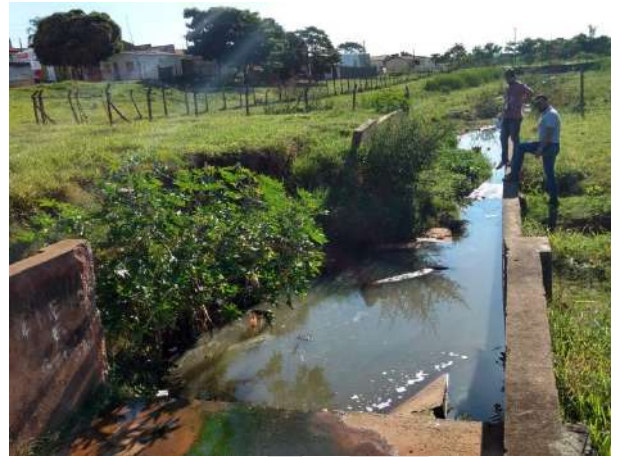
Foto 6.52 – Escada hidráulica – Vista do desmoronamento
