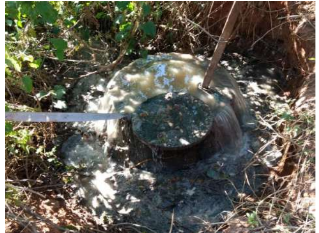
Foto 6.33 – PV transbordando e despejando esgoto na voçoroca
