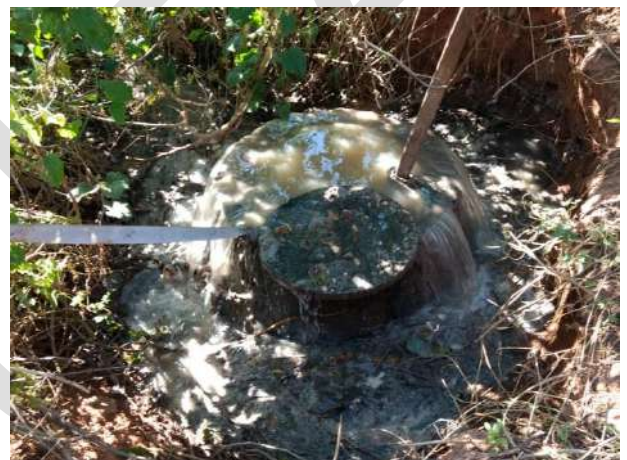
Foto 6.50 – PV transbordando e despejando esgoto na voçoroca
