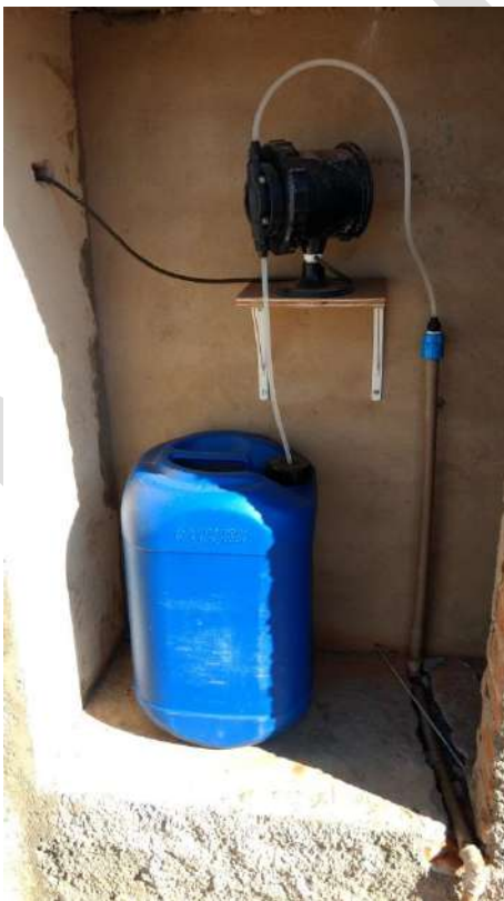
Foto 6.19 – Desinfecção no poço através de bomba dosadora
