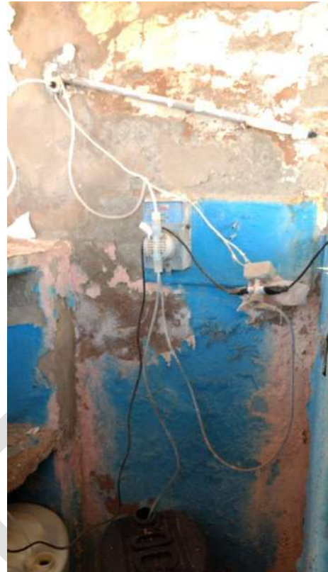
Foto 6.22 – Desinfecção no poço através de bomba dosadora
