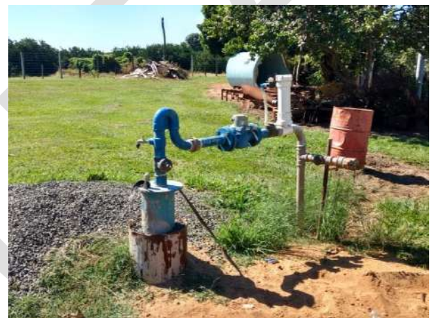
Foto 6.16 - Identificação do Poço: P09 – Álvora
